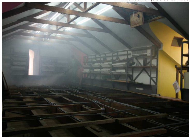
▲ Charpente endommagée de l'Alliance
