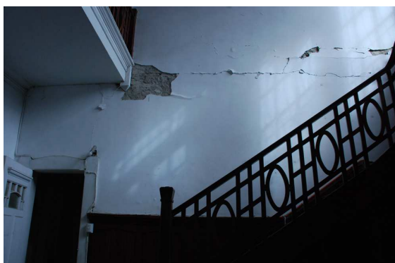
Un mur endommagé du bâtiment
